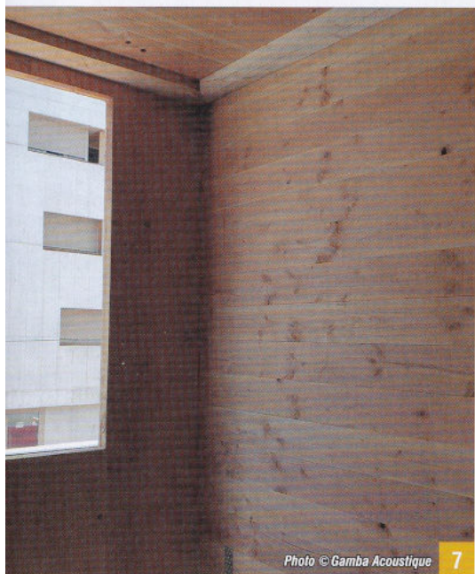
Photo © Gamba Acoustique 7
