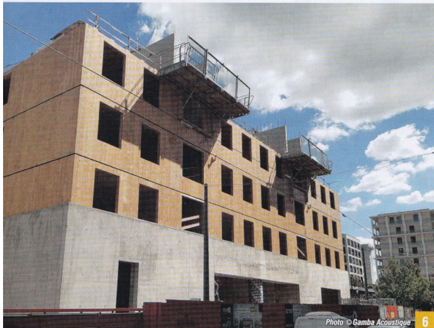
Photo © Gamba Acoustique 6
